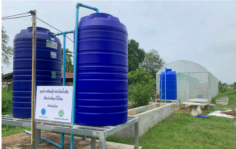
รูปที่ 2 แสดงการติดตั้งโรงเรือนเชื่อมต่อกับระบบบึงประดิษฐ์แบบน้ำไหลใต้พื้นผิว
