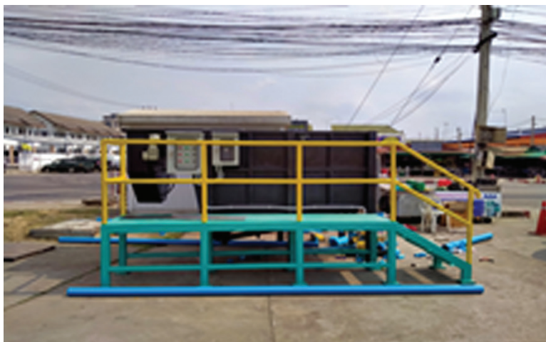
รูปที่ 6 ถังแยกไขมันแบบอัตโนมัติติดตั้งบริเวณลานจอดรถตลาดไนท์บาซาร์
